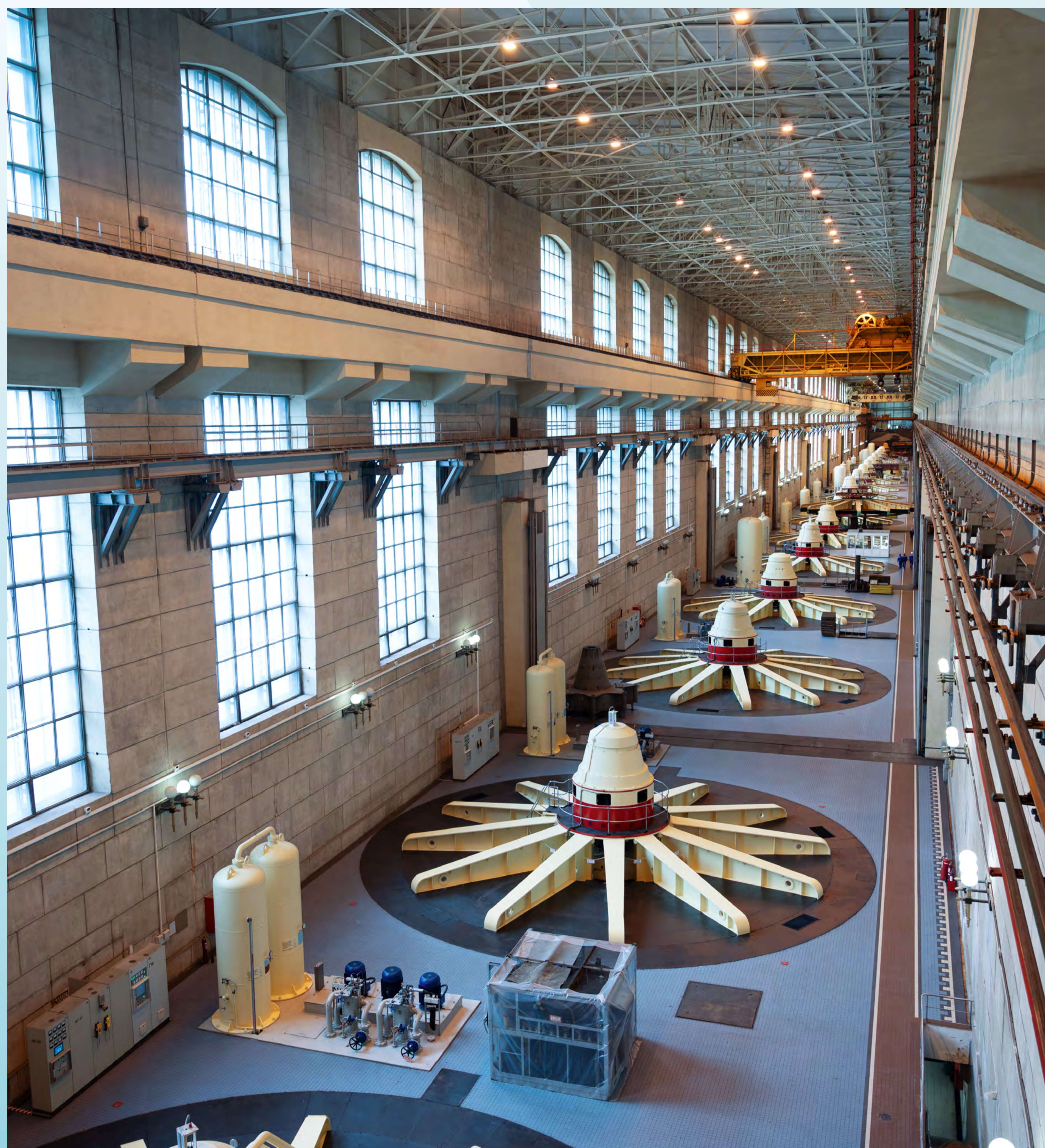
Машинный зал Жигулёвской ГЭС
